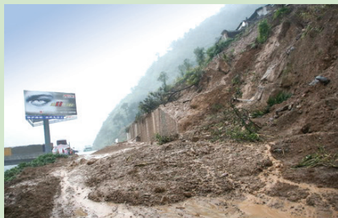
泥石流冲断云南昭通公路
