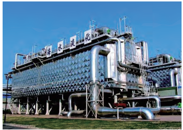
首钢京唐海水淡化工程
