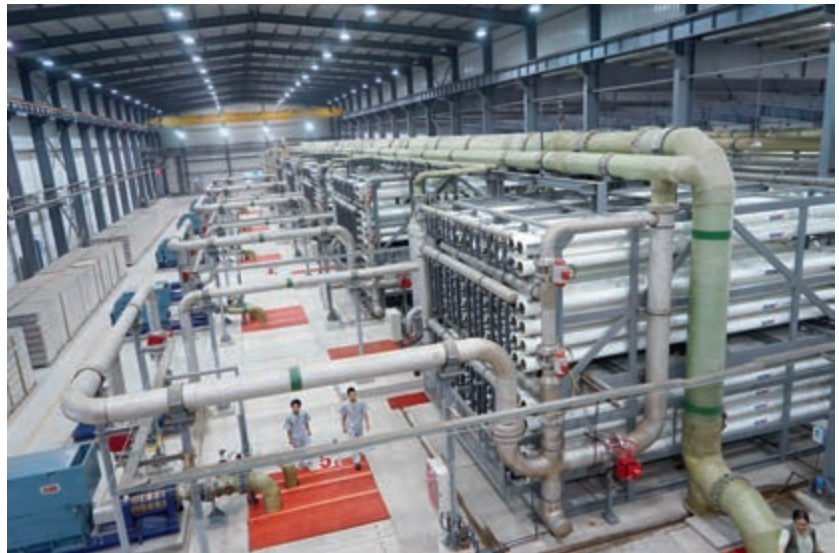
图 3.14 河北唐山曹妃甸的海水淡化车间
