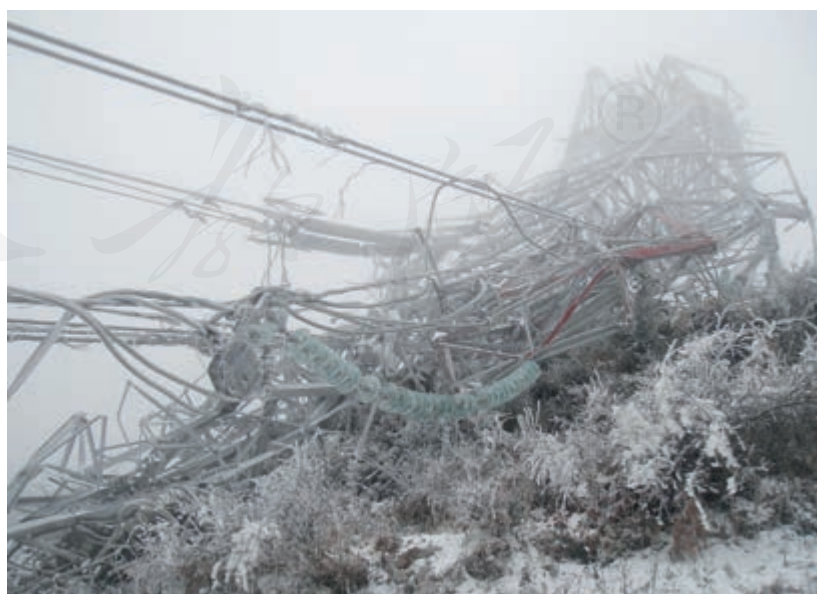
图6.8 寒潮破坏输电线路
